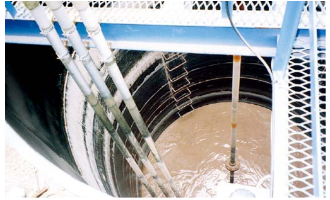
● スラリータンク
